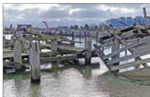
In manchen Häfen wurde nach dem Ostseehochwasser noch nicht mit den Reparaturen begonnen. Seite 16
