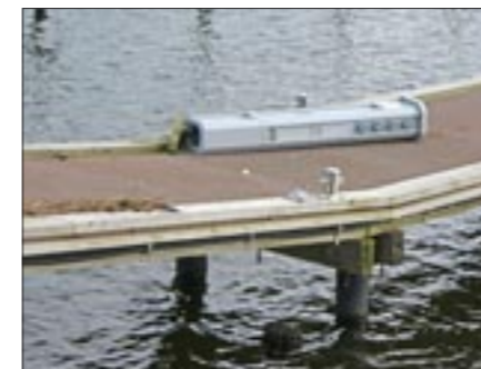
Die abgebrochenen Stromsäulen liegen seit knapp 5 Monaten auf den Stegen in Maasholm, die alle abgesperrt sind.
