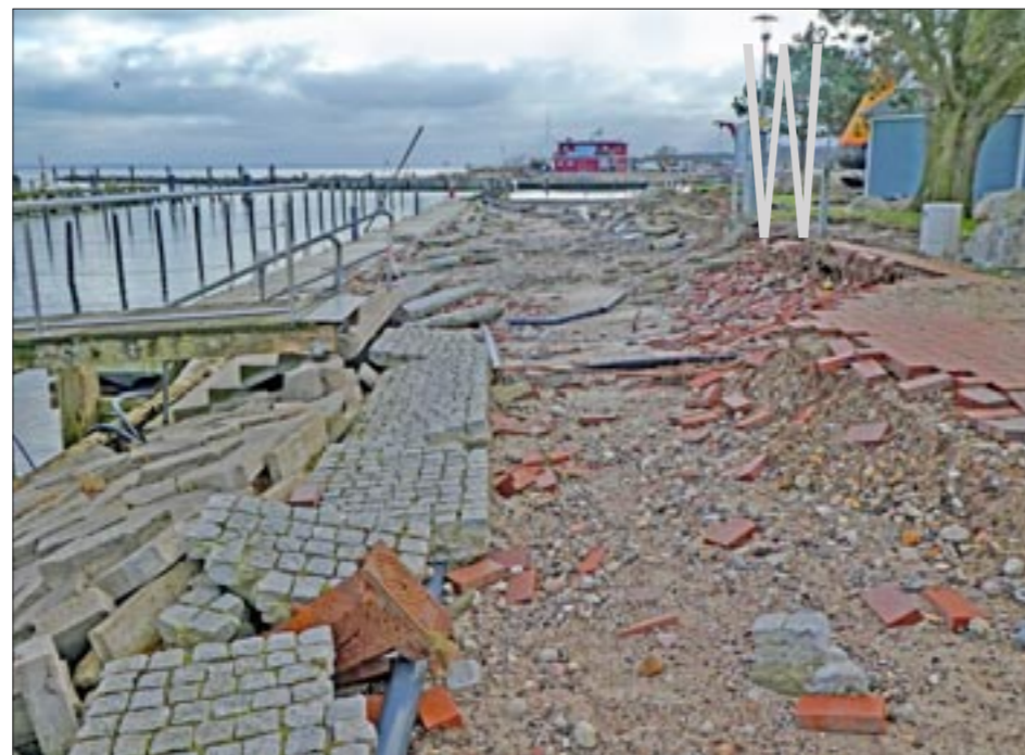
Nicht nur Brücken und Stege wurden durch die Wellen zerstört, sondern auch Uferbefestigung und Promenaden.
